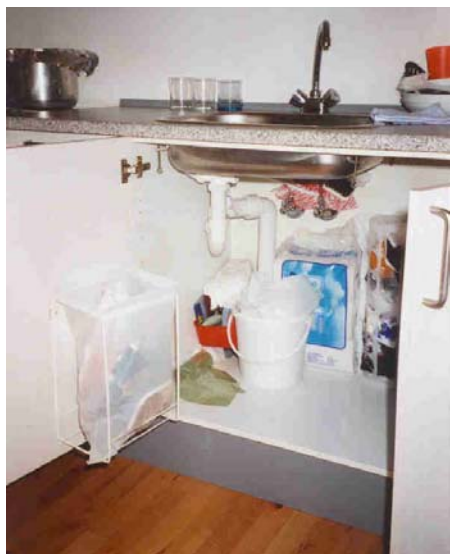
Rørføring under køkkenbord
