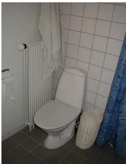
Toilet placeret for tæt på radiator!
